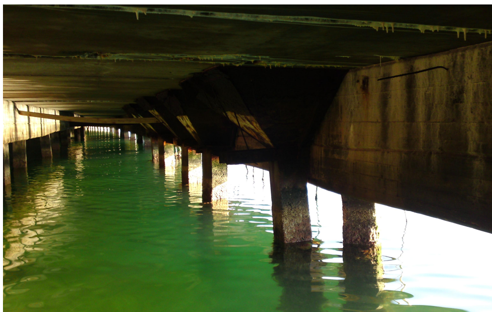
Bild 5 Tidigare utförd förstärkning av yttre pårad på grund av påkörning.
